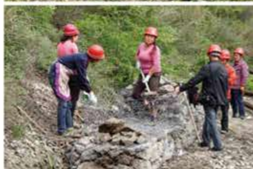
▲ 綿竹市の施工地視察 ▼ 技術者養成の研修。試験施工地を設け現地踏査から施工までの行程をモデル的に実施した。
