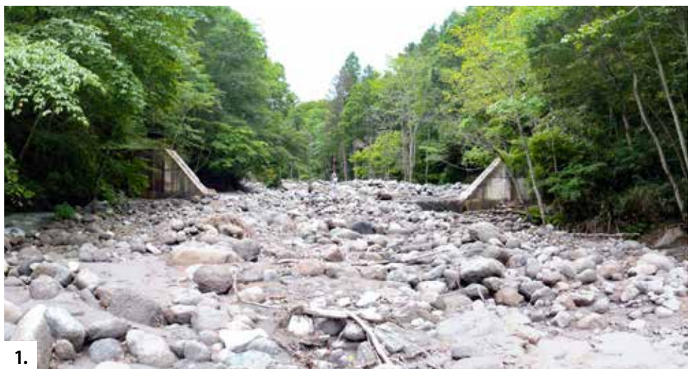
メイン写真. 増厚および嵩上げ後の H1 既設治山ダム工。 1. 土石流で埋没した H1 既設治山ダム工。
