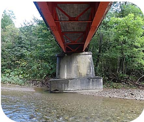
傾いた橋脚の状況
