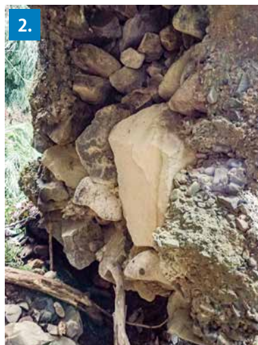
トップ写真：既設谷止工下流に施工された新設谷止工。 1. 破損した既設谷止工。 2. 既設谷止工内部の玉石コンクリートの状況。
